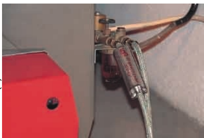
Exemplu de montaj pe admisia de motorină a unei centrale termice
